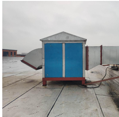
焊接废气排气筒
