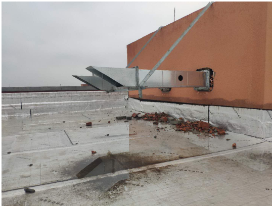
抛丸粉尘排气筒
