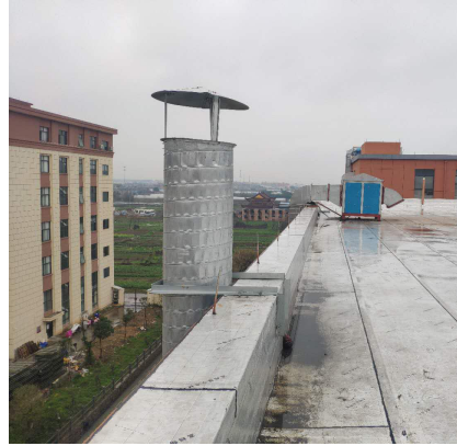
注塑废气排气筒
