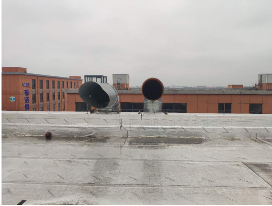
左：喷塑粉尘排气筒 右：燃气废气排气筒
