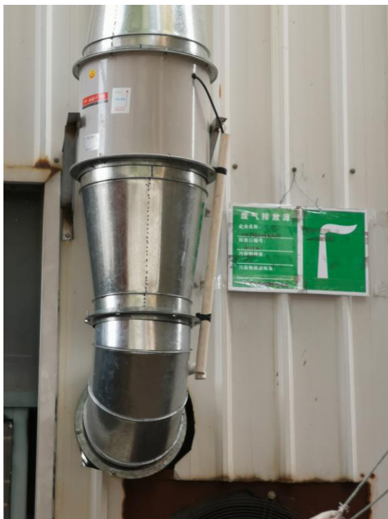
焊接废气排放
