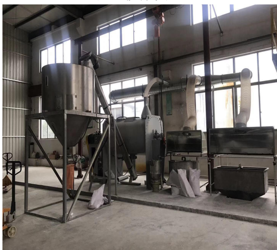
投料搅拌设施
