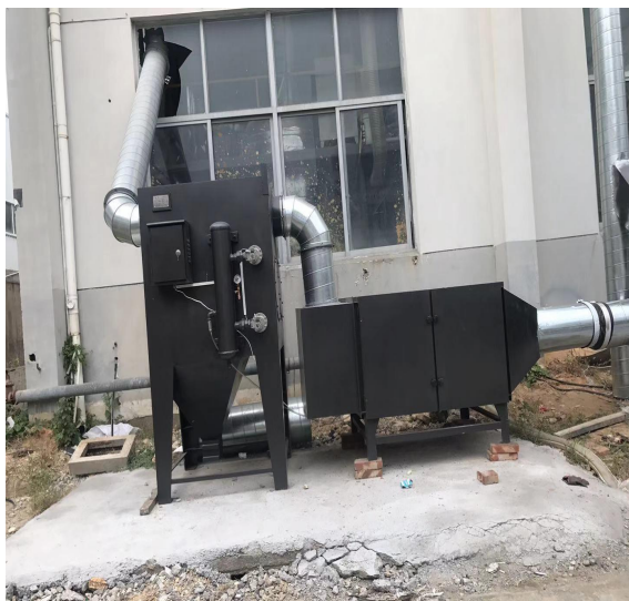
加热搅拌废气处理设施
