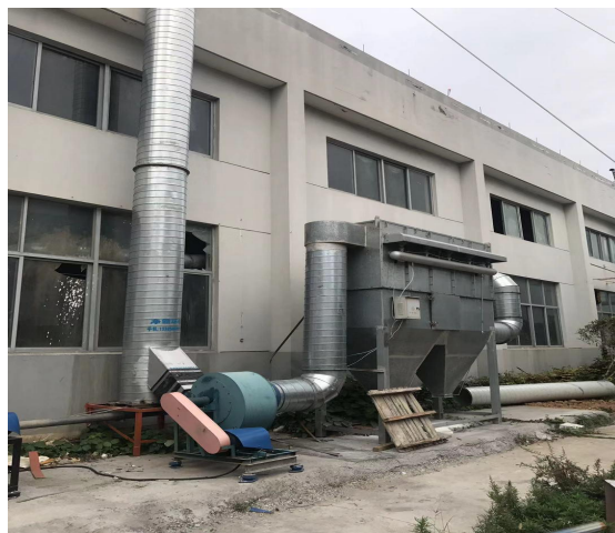
布袋除尘设施
