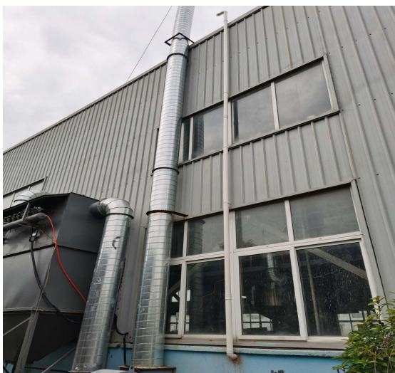
废气处理设施
