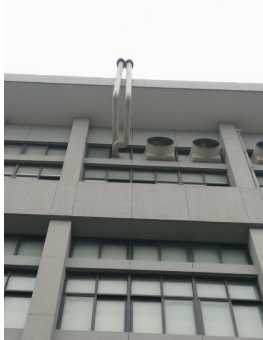
抛光、抛丸废气排气筒
