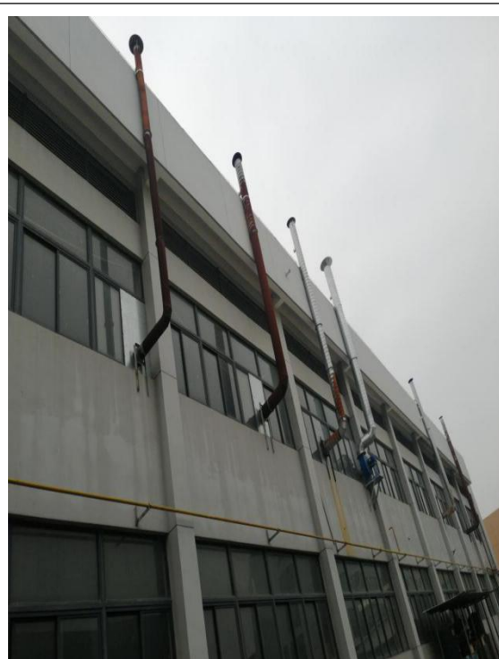
网带炉废气排气筒
