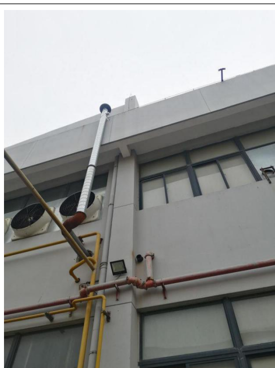
脱模废气排气筒
