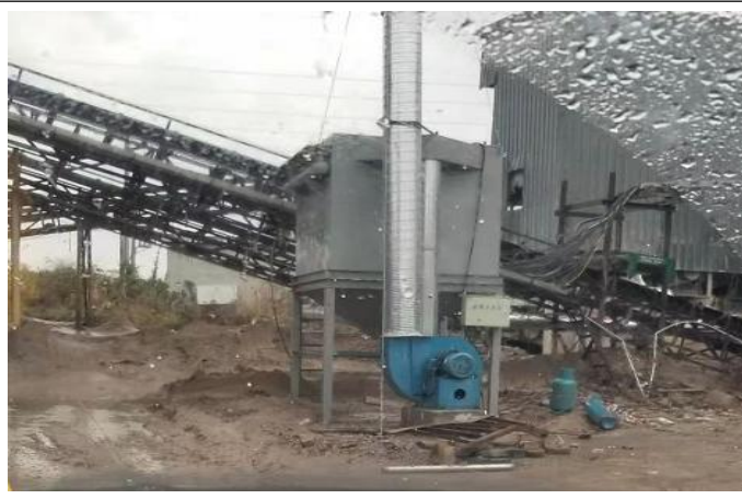
废气处理设施
