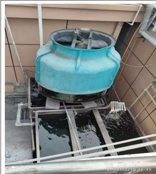
熔化、浇铸冷却水回用水池
