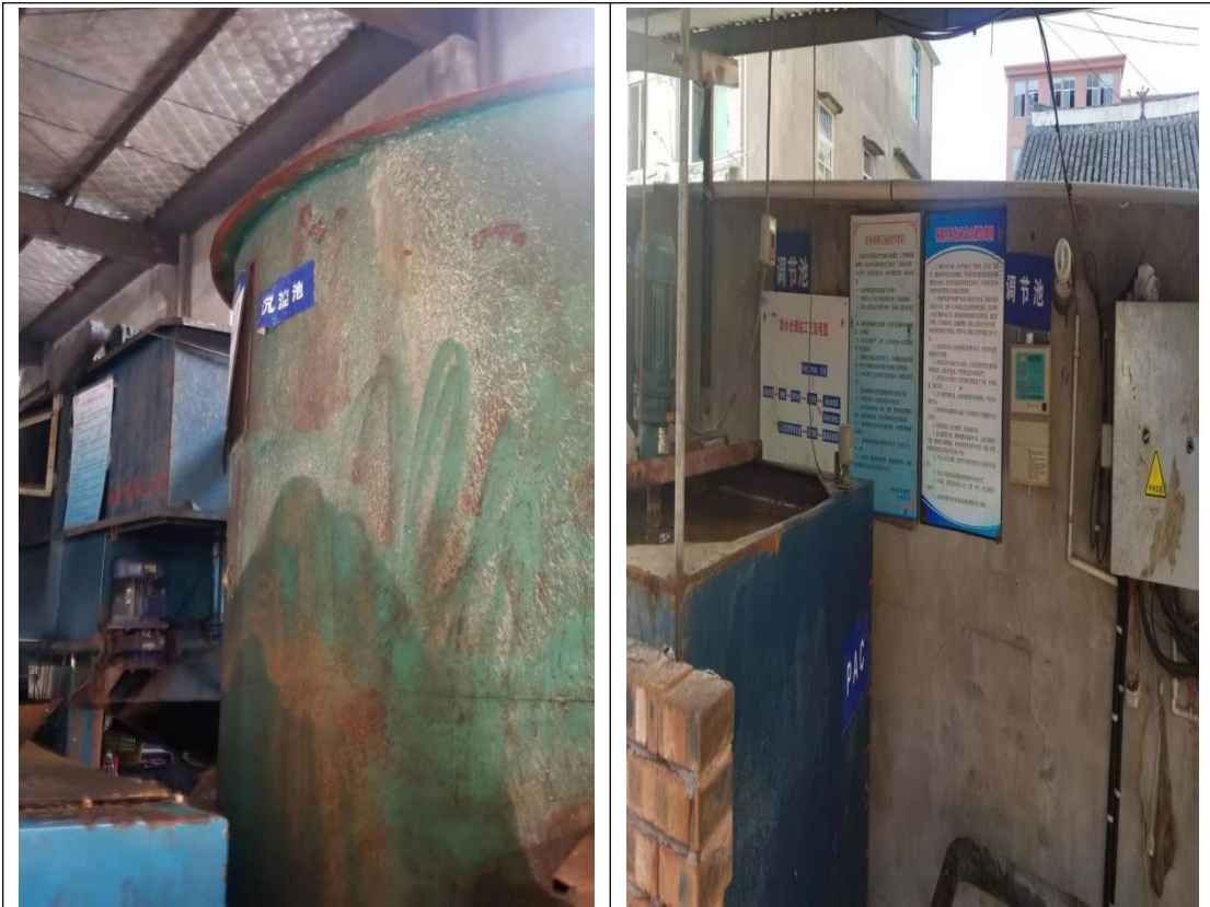
废水处理设施
