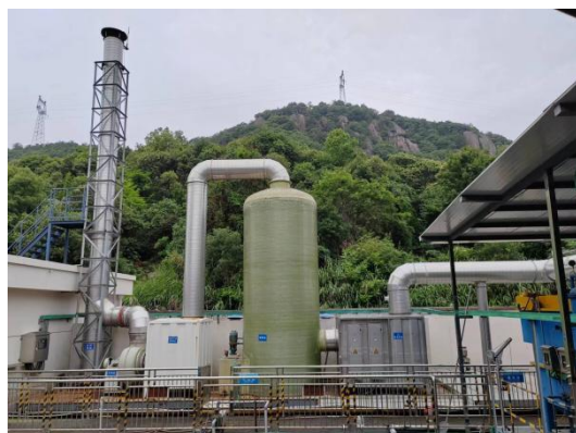
废水处理站废气处理设施
