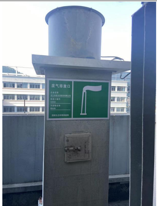
磨边粉尘（北）废气处理设施出口
