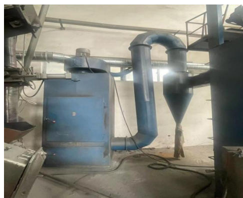
抛丸废气自带除尘设施
